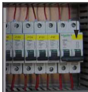
Interruttore UPS (-F5) Posizionato nell'armadio centrale +H1
